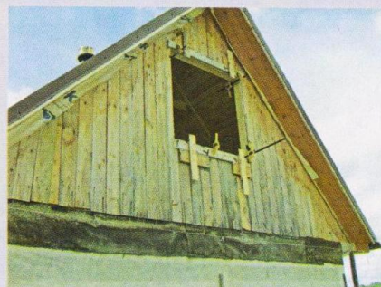
Сверху и снизу проёма установил упоры, определяющие положение оконной рамы относительно обшивки фронтона.
