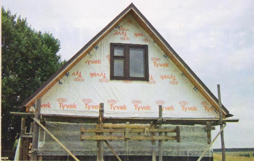
Прочная плёнка надёжно защитит от атмосферных осадков черновую обшивку фронтона и находящуюся за ней теплоизоляцию.
